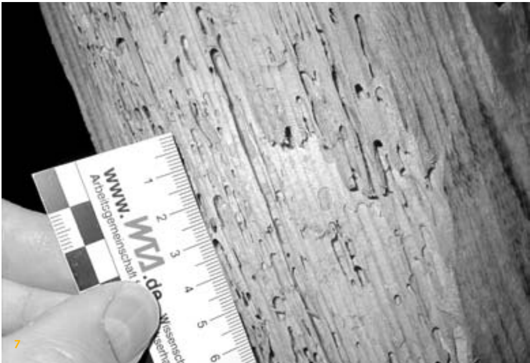
7 Typische Spuren eines Hausbock-Befalls im Dachtragwerk eines Wohnhauses
